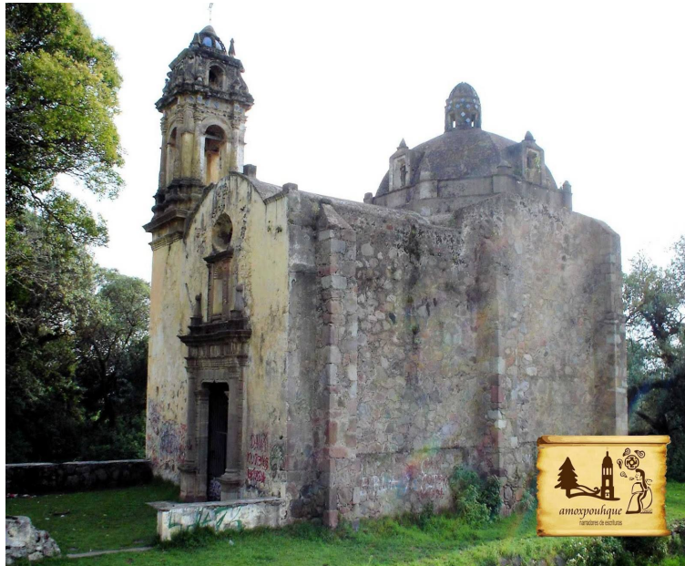
Capilla de la ex hacienda de Tomacoco. Luce también, muy deteriorada, por el descuido lamentable de las autoridades y de la sociedad de Amecameca
